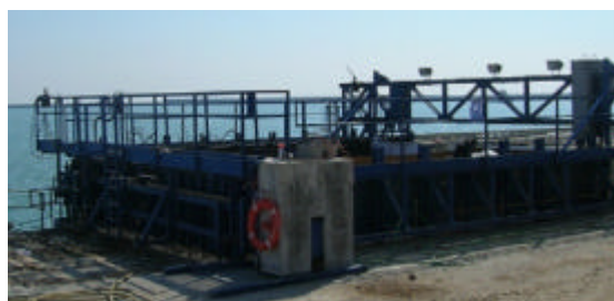
Fig. 7: Carro de encofrado utilizado en la sección de estudio.
